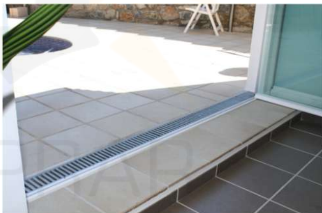
Embutido con desagüe
